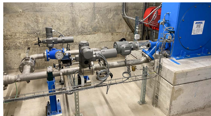
Turbinenanlage im Trinkwasserkraftwerk Pörter in Giswil: Energiegewinnung als «Abfallprodukt» der Wasserversorgung. (Bild: Wasserversorgung Giswil)
